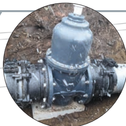
農水パイプライン スプーンMジョイント バルブ取り替え工事現場
