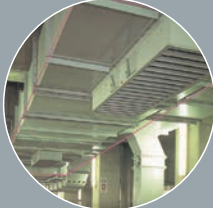
工業用硬質塩化ビニル押出板 廃液処理槽(角ダクト・吹出口) 施工現場
