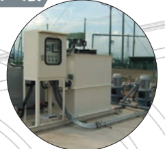
連続式pH中和装置 TPC型 施工現場
